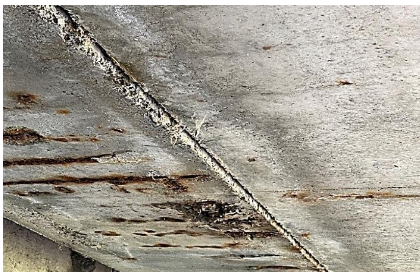
Рисунок 12 — Замокання бетону плит та руйнування бетону з оголенням та корозією арматури
