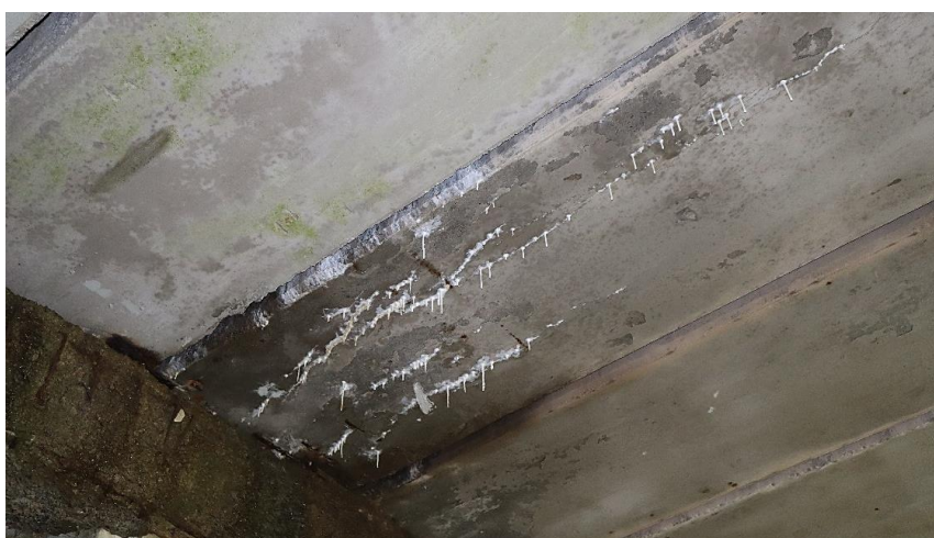
Рисунок 8 — Поздовжні тріщини у місцях розташування пустот. Вилугування бетону у вигляді сталактитів
