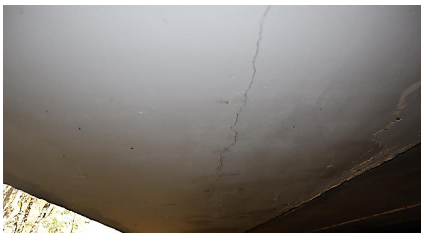
Рисунок 10 — Поздовжня тріщина на нижній грані плити
