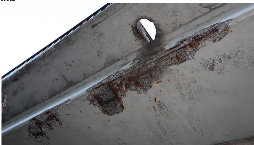
Рисунок 9 — Руйнування захисного шару бетону з оголенням та корозією арматури плити внаслідок її тривалого замokання
