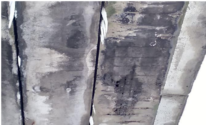
Рисунок 13 — Наскрізні руйнування бетону нижньої грані плити, оголення та корозія арматурного каркасу. Затікання води
